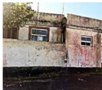
Figura 3 - Fissuras nas paredes
